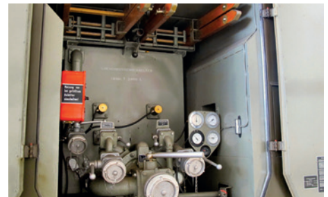
Blick auf die Leitern, die Kreislumpumpe und den Löschwassertank, Foto: FMSH
