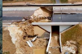
Direkt neben einer Unterführung des Elbe-Seitenkanals befand sich die Dammbuchstelle, Foto: mg
